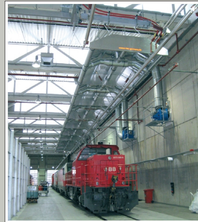
Absaughaube bei der ÖBB, Länge 40 m, mit Segmentabsaugung über Rauch- und Wärmemelder beim Ein- und Ausfahren der Dieselloks in die Abstellhalle zur Einhaltung vom Gesundheitsschutz am Arbeitsplatz (analog unserer TRGS 554).
