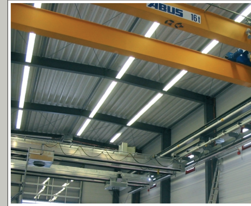
Abgasabsauganlage für Dieseltriebwagen und Dieselloks in einer Servicewerkstatt bei der Westerwaldbahn mit einer kranähnlichen Saugschlitzkanalanlage Typ SSK 900 – 60 m lang – mit zwei Absaugbrücken Typ SSK 900 – 14 m breit – freitragend und in drei Achsen verfahrbar.
