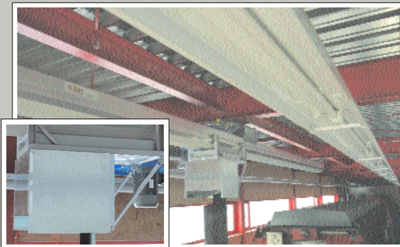
Diesellokabsaugung, mitfahrend und automatisch ablösend für die Feuerwehr der SBB am St. Gotthard-Tunnel mit 5.000 m³/h über eine Saugschlitzkanalanlage Typ SSK 580 kombiniert mit einer Mitfahr- und Ablöseeinrichtung Typ Firemaster.
