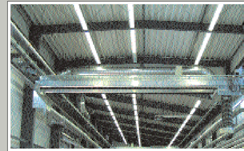
Diesellokabsaugung mit Absaugbrücke und teleskopierender Absaughaube – 2 m lang – in NW 355 für 6.000 m³/h.
