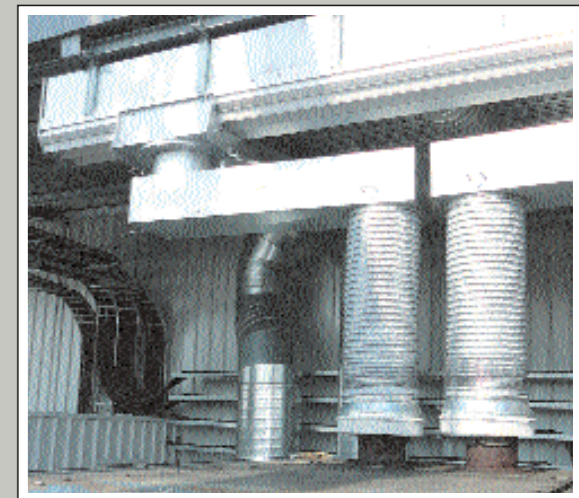
Zwei Absauglaufwagen NW 560 für ein Dieselnotstromaggregat 1.100 KVA teleskopierend mit einer Ausladung von 2,5 m für einen Absaugvolumenstrom von 25.000 m³/h.
